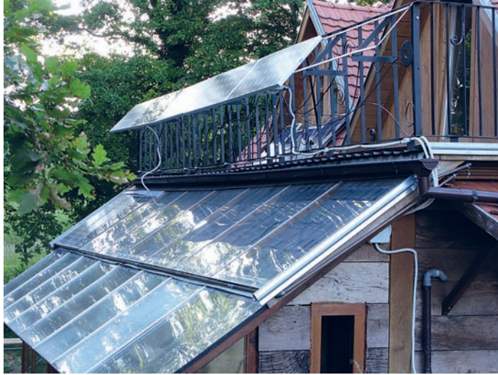
SLIKA 6 Solarni toplinski kolektori i fotonaponski paneli na krovu
