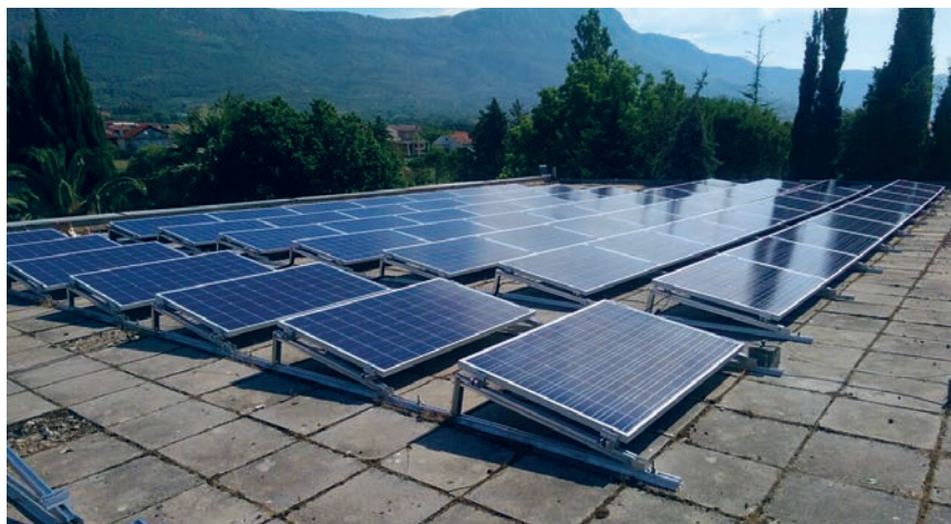
Solarna elektrana na krovu škole
